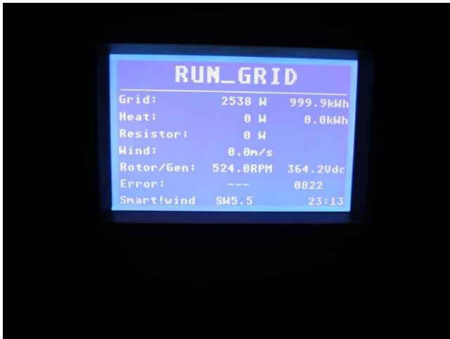
Anzeige im Display: Die erste Megawattstunde
