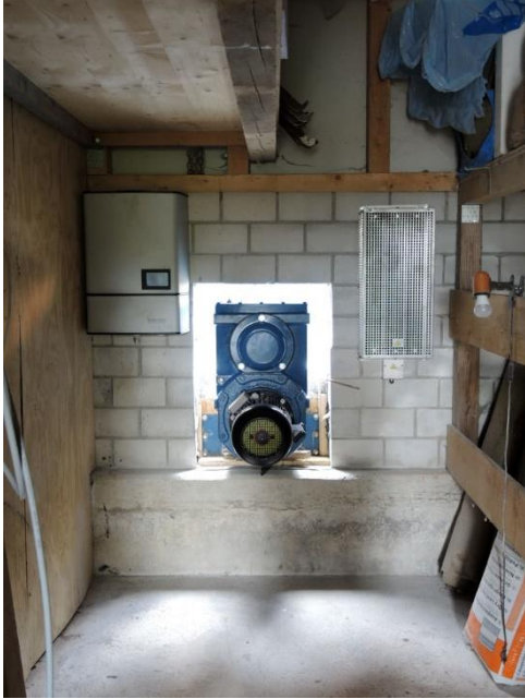
Getriebe, Generator, Frequenzumformer
